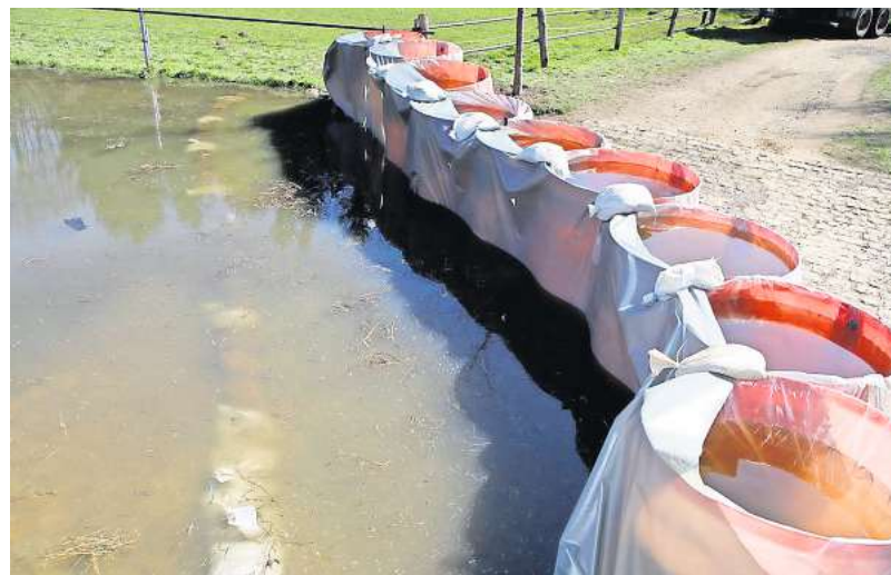
So sieht das Aquariwa-System im Einsatz aus.
